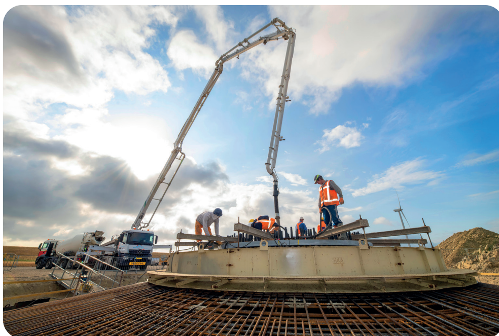
In 2023 zijn de funderingen voor de nieuwe windturbines van windpark Oostzeedijk gestort.
